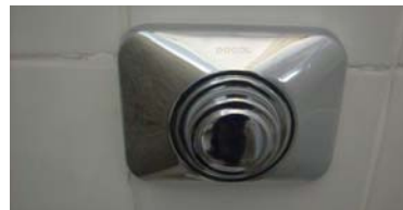
Válvula 6 litros/descarga anti vandalismo após as intervenções
