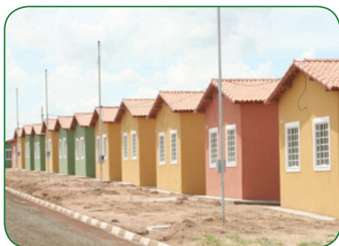
Figura 6 – Falta de venezianas em janelas de habitações da CDHU.
