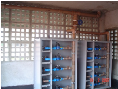
Figura 4.1 – Abrigos metálicos no barrilete
