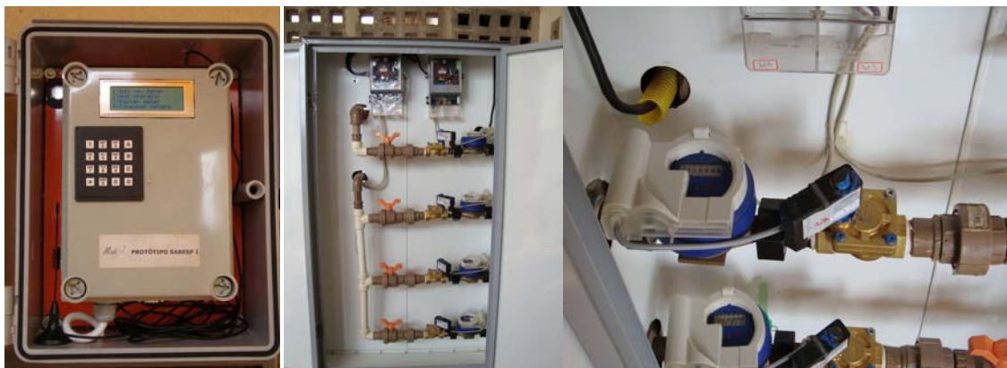
Figura 4.3 – Da esquerda para a direita :Concentrador de dados,caixa de medição individualizada e detalhe do medidor e válvula de corte remota no Coniunto Habitação de Itapetininga
